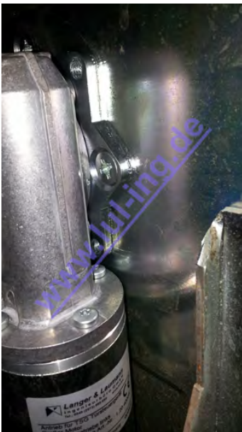
Abb. 9: TSG Antrieb – eingebaut, Sicht von Rückseite
