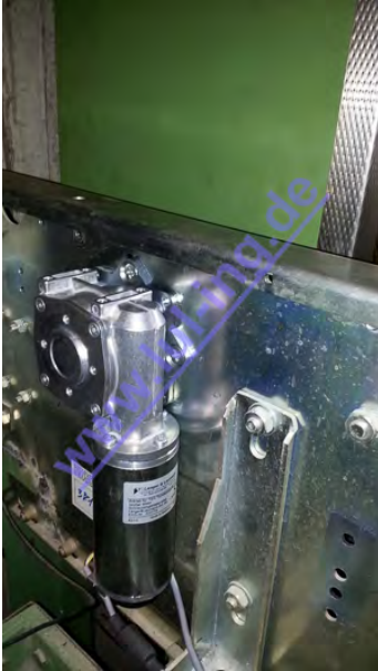
Abb. 8: TSG Antrieb – eingebaut, Sicht von Rückseite
