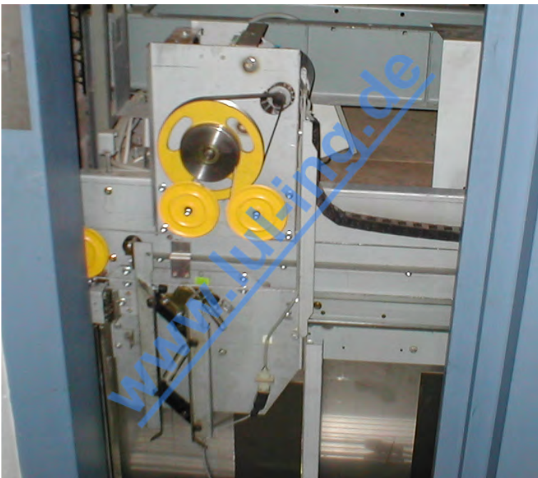
Abb. 2: KONE ADX vor dem Umbau (hier: KONE ADX TR)
