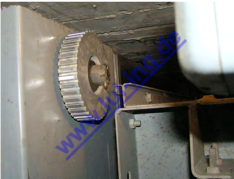
Abb. 3: Thyssen M2 vor dem Umbau: Version mit altem Zahnrad
