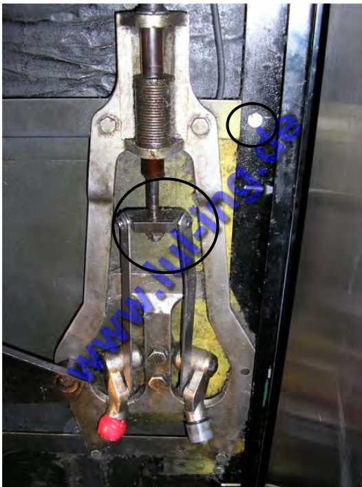
Abb. 12: Alte Schachttürmitnahme im eingebauten Zustand
