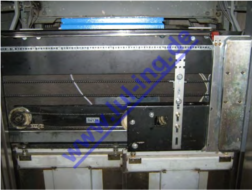
Abb. 5: fertig umgebaute Türmaschine mit TSG
