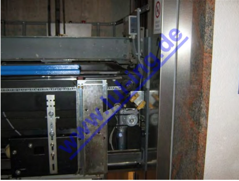
Abb. 3: fertig umgebaute Türmaschine mit TSG - Schließseite
