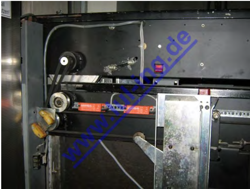
Abb. 1: Schmitt & Sohn Türantrieb vor dem Umbau
