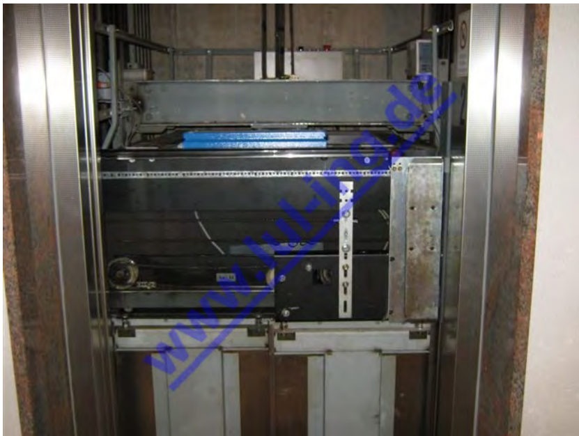
Abb. 2: fertig umgebaute Türmaschine mit TSG
