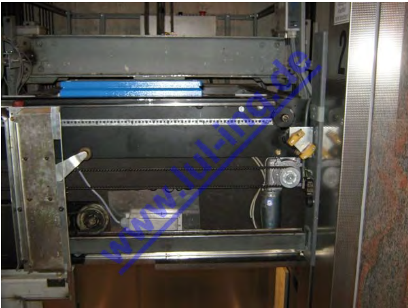
Abb. 4: fertig umgebaute Türmaschine mit TSG - Schließseite
