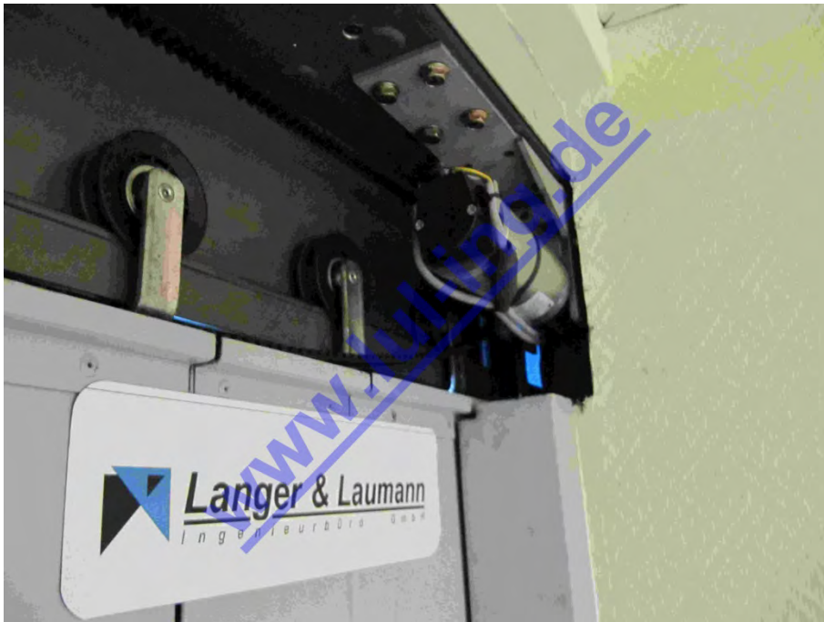
Abb. 3: TSG in Peigen Schachttür - Motorhalterung
