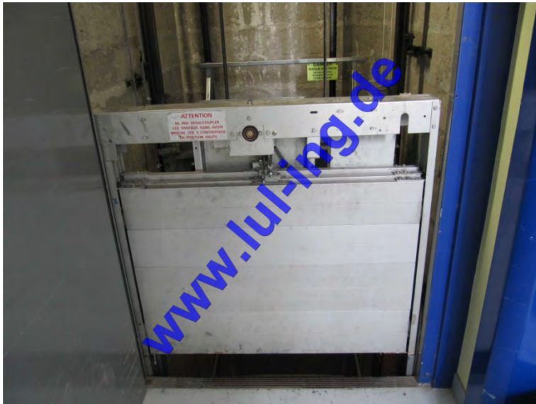
Fig. 1: Opérateur Otis Vertica avant le remplacement
