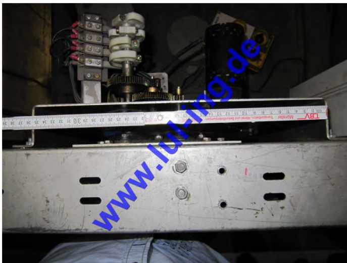
Fig. 2: Opérateur Otis Vertica avant le remplacement
