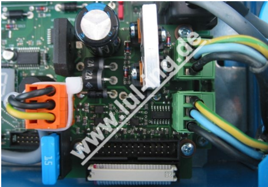
Abb. 5: TSG Elektronik mit Erweiterungsplatine für Ansteuerung L&L Riegelkurve
