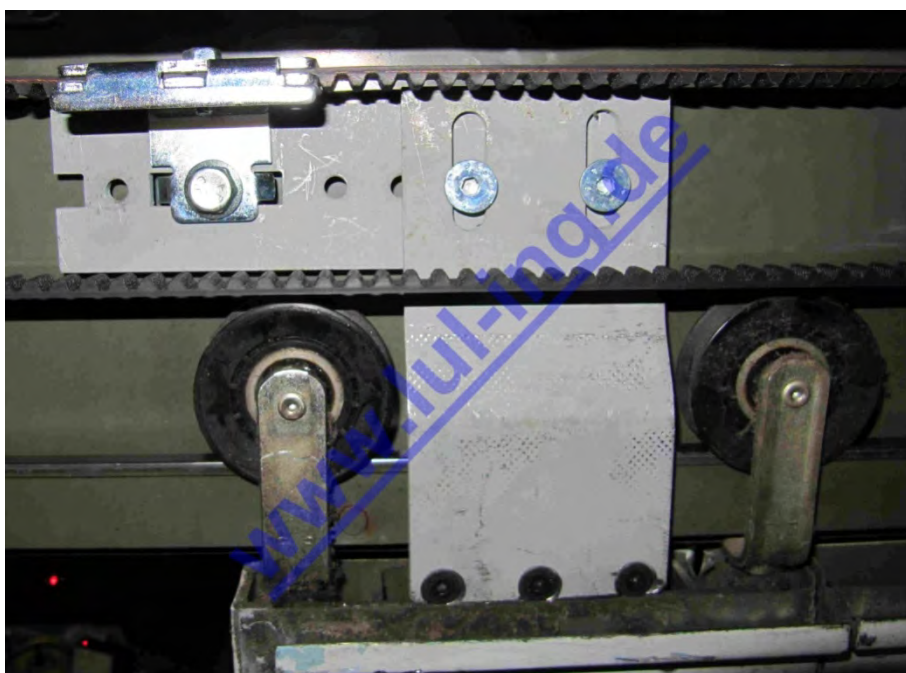
Img. 6: Peignen A30 remplacée par le TSG, l'entraînement du vantail
